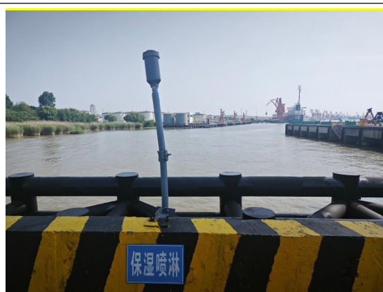
定点喷淋设施
